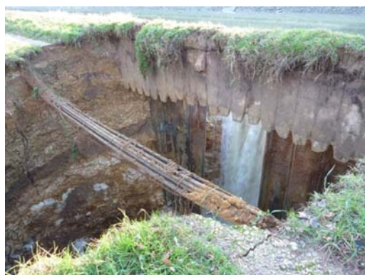
FIGURE 7 : BRECHE OBSERVEE AU NIVEAU DE LA STEP EN 2011
