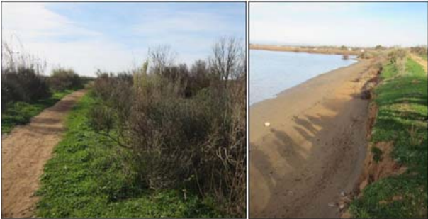
FIGURE 5 : DIGUE AGRICOLE ET EROSION EXTERNE
