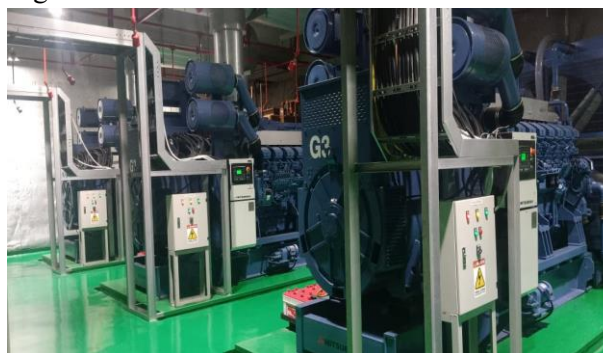
Gambar 8, Genset yang terpasang dengan kapasitas 2250kVA
