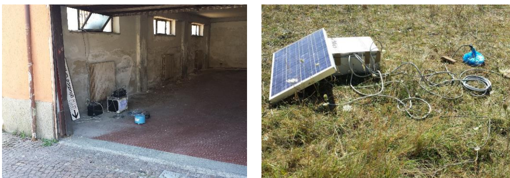
Figura 6. Installazione della stazione MN08 (a sinistra) a Montereale e CP06 (a destra) a Capitignano.
