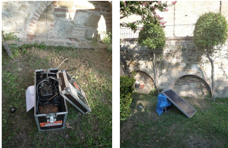
Figura 3. Installazione della stazione AM03 presso l'ospedale di Amandola.
