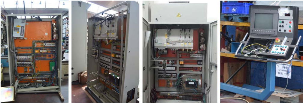
Desmontaje y revisión de elementos electrónicos y de control.
