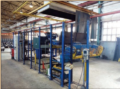
ROBOT DE SOLDADURA MOTOMAN TRAS 3100 7 Ejes controlados y Posicionador de 5 ejes controlados.
