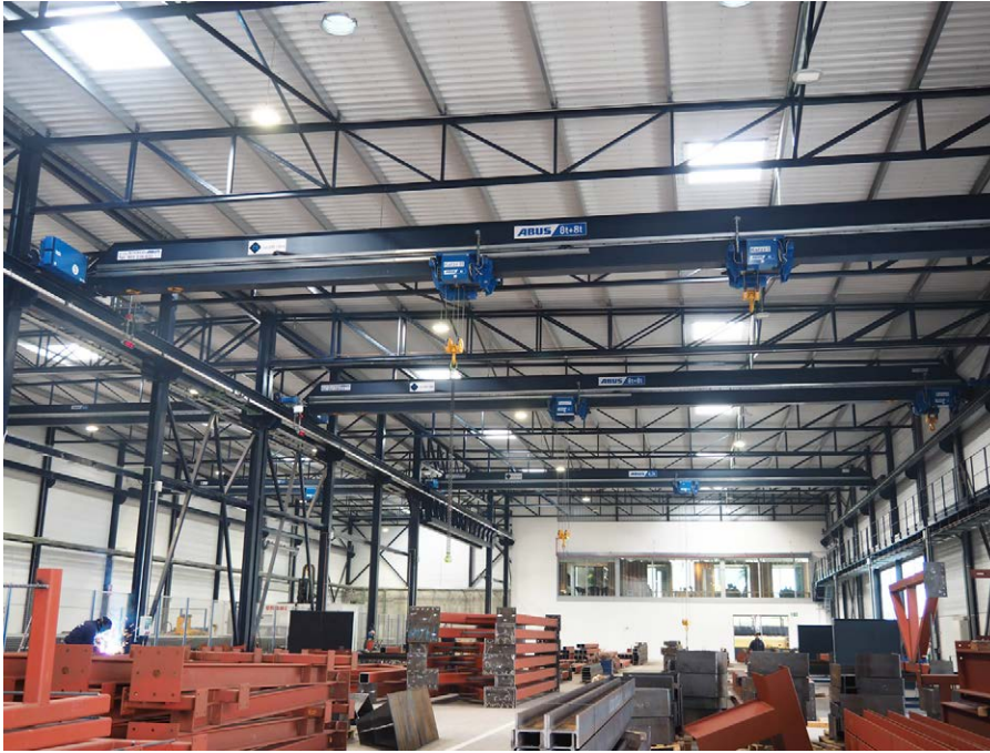
Las grúas Abus están situadas en las zonas de oxicorte, mecanizado y granallado.
