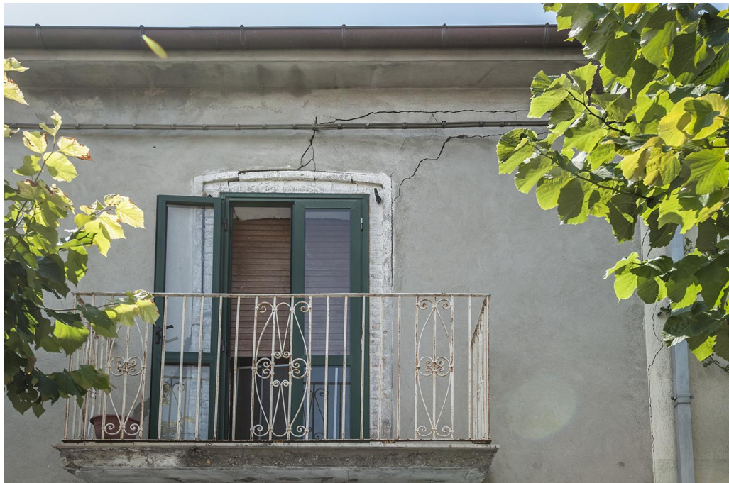
Foto 5. Palata. Aggravamento di probabili fessurazioni preesistenti, edificio tipo B.
