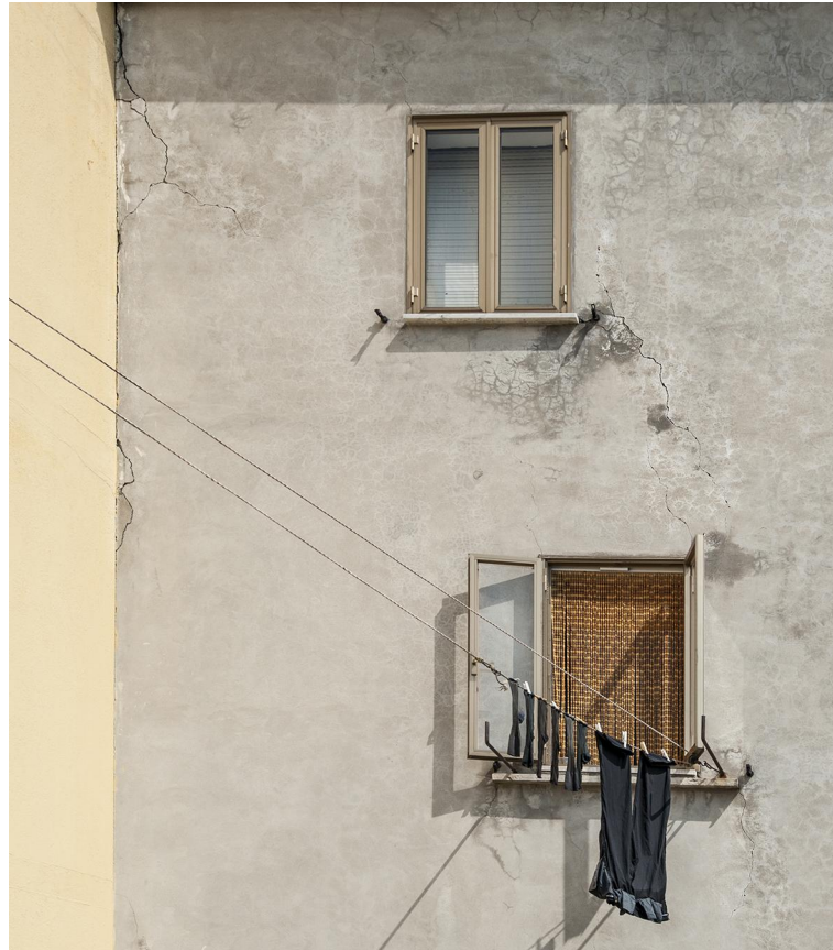
Foto 1. Palata. Fessurazioni leggere, edificio tipo B.
