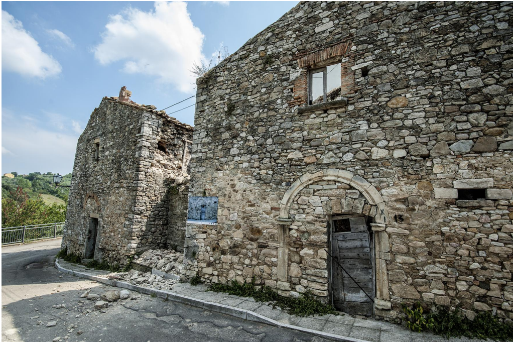
Foto 2. Acquaviva Collecroce. Crollo parziale in edificio fatiscente.
