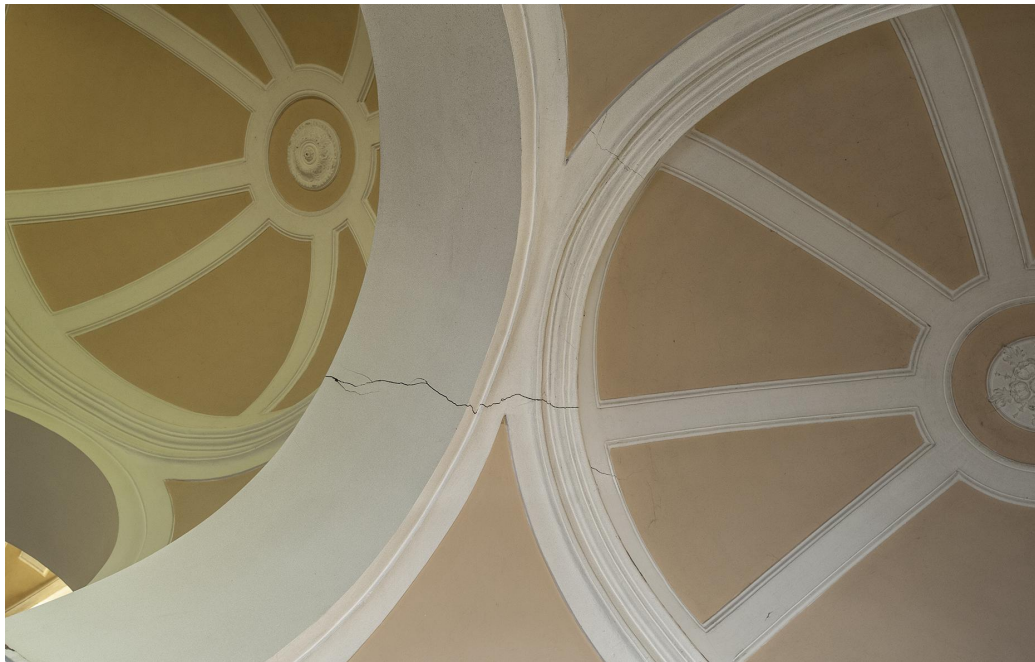
Foto 4. Acquaviva Collecroce. Fessurazioni all'interno della chiesa parrocchiale.
