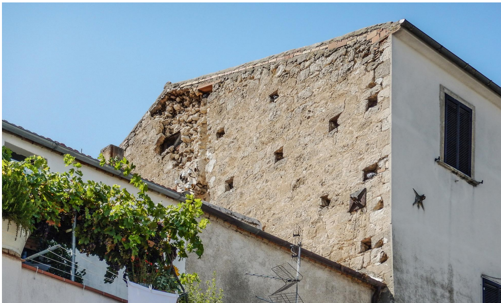
Foto 3. Montecilfone. Caduta di porzione di paramento in edificio in pietra. Notare la presenza di una vecchia canna fumaria a destra della porzione crollata.
