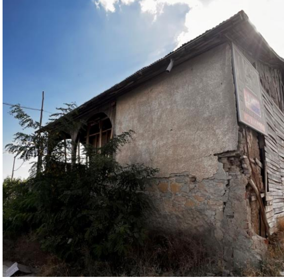
Resim 34. Doğu cephedeki bozulmalar
