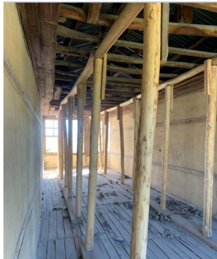
Resim 53. 2-02 mahalindeki sökülen ahşap tavan, döşemedeki deformasyon
