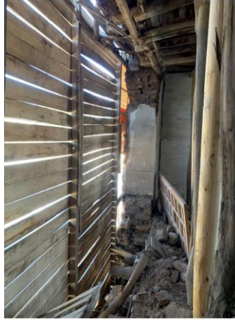
Resim 49. Yıkılan kuzey duvarı, boşluğu kapatmak için eklenen kereste çatki
