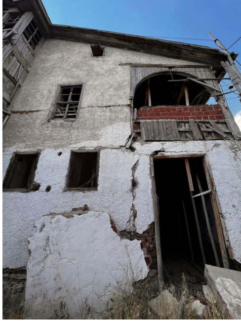
Resim 33. Güney cephedeki bozulmalar
