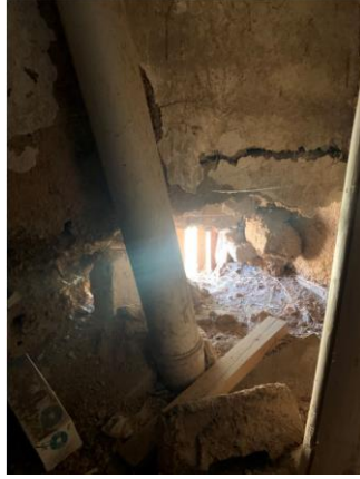
Resim 38. Z-02 mahalinde insan eliyle yıkılmış duvar ve gider borusu.
