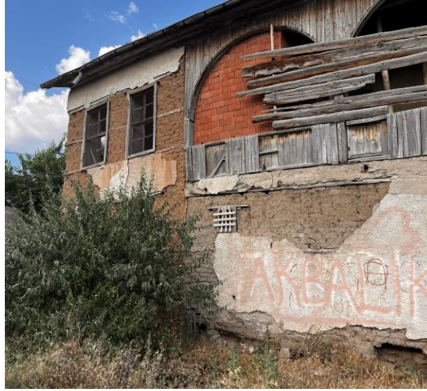
Resim 35. Batı cephedeki bozulmalar
