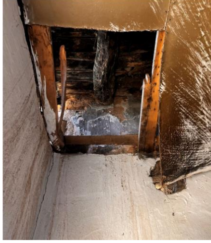
Resim 40. Z-04 mahal tavanındaki yanma ve sunta ile kapatılan tavan
