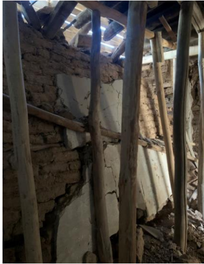
Resim 44. Z-08 mahalinde yıkılan kuzey duvarı
