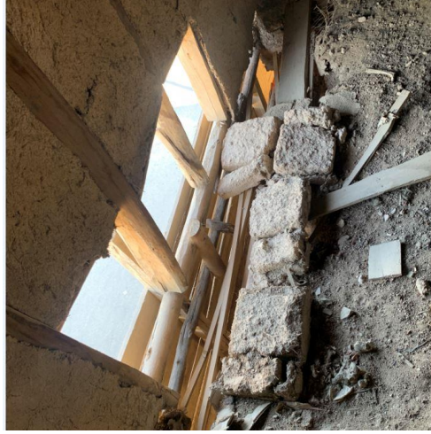
Resim 54. 2-03 mahal döşemesindeki döşeme çökmesi ve kuzey duvarındaki malzeme kaybı
