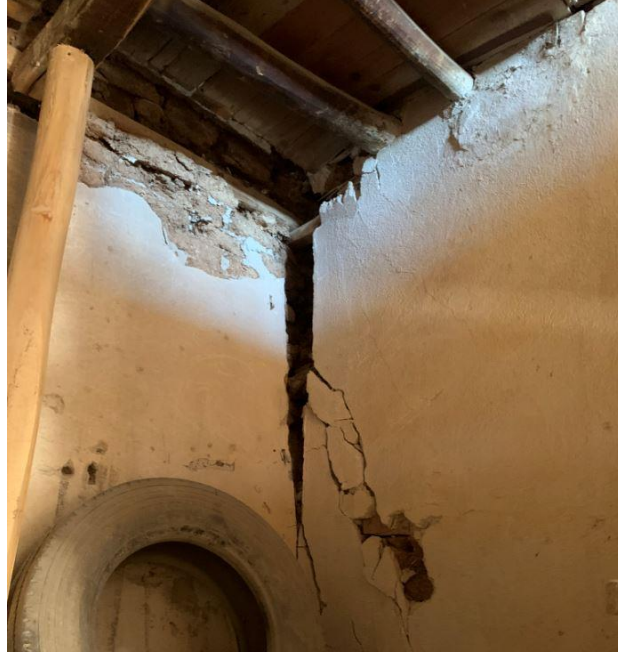
Resim 41. Z-05 mahalindeki duvarda ayrılma ve yapısal çatlaklar
