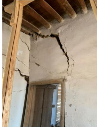
Resim 48. 1-06 mahaline açılan K9 kapısı ve duvardaki yapısal çatlaklar
