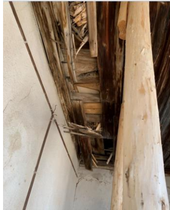
Resim 51. 1-08 mahal tavanındaki kısmi çökme
