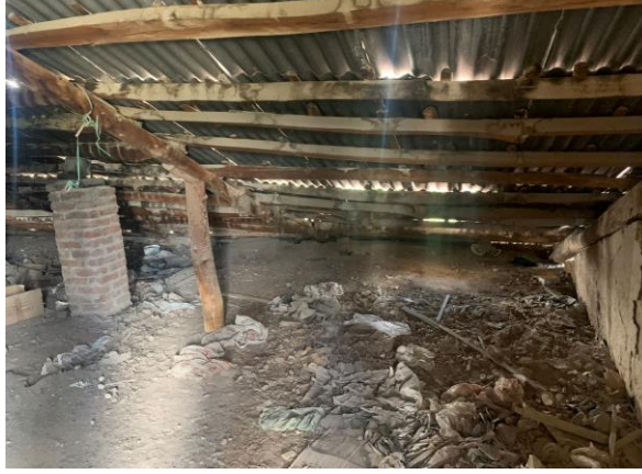
Resim 52. 2-01 mahali döşemesindeki bozulmalar
