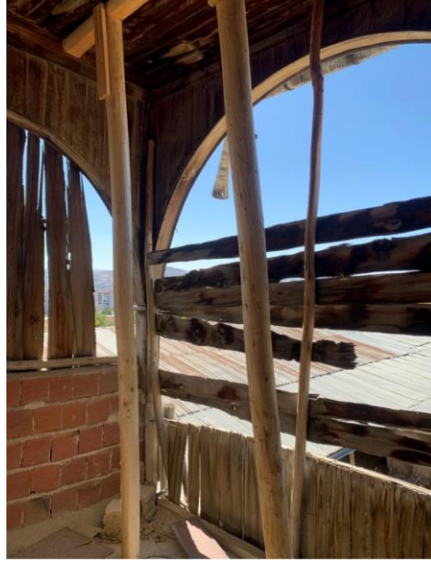
Resim 46. Kemerlerdeki deformasyonlar ve sonradan yapılan eklemeler
