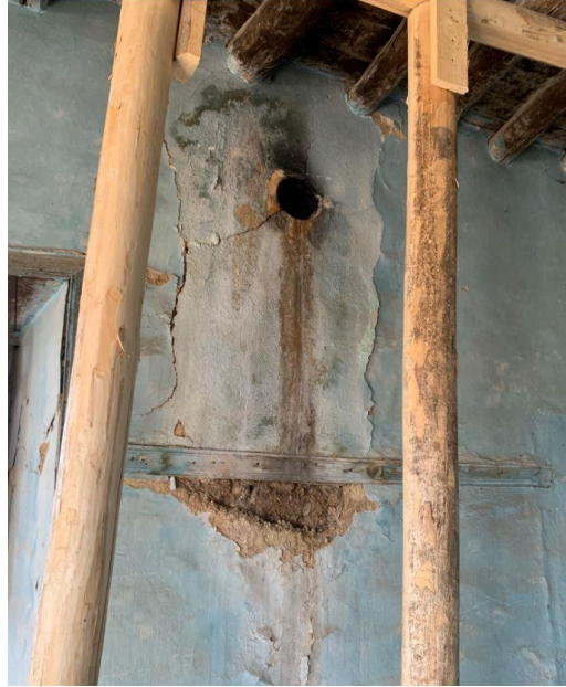
Resim 47. Batı duvarındaki bozulmalar
