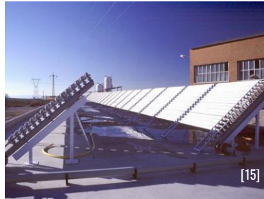
Central demonstradora, Hidrocen, Madrid
