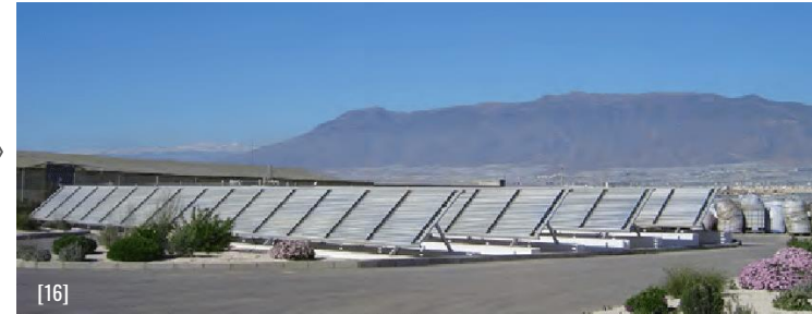
Central demonstradora, La Mojenera, Almería
