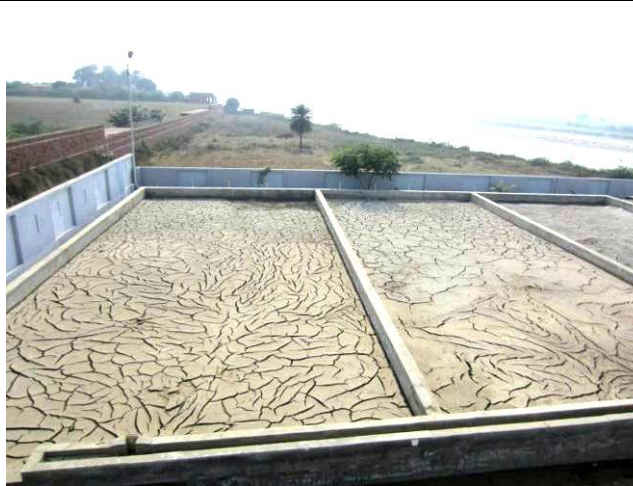
(D) Sludge Drying Beds
