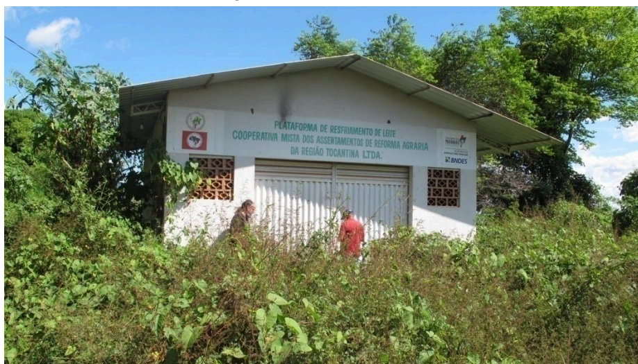
Foto 5 – plataforma de resfriamento de leite, desativada, em fase de adaptação para configuração de queijaria, com objetivo de produção da ordem de 30 kg/dia. As plantas estavam em elaboração. Esperava-se início de atividade para setembro/23.
