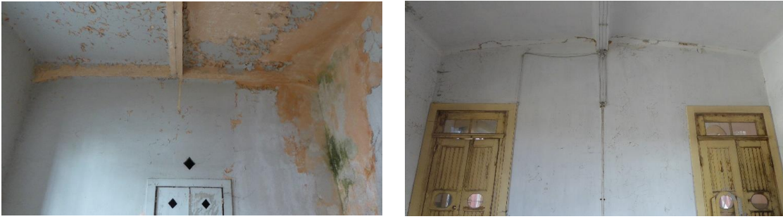
Figura 19: Inventariação, inspeção e diagnóstico - Fotografias de apoio à inspeção e diagnóstico evidenciando a infiltração de água pelos edifícios adjacentes e fissuras em elementos estruturais fruto da movimentação dos elementos estruturais que sustentam o edifício
