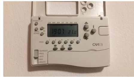
Figura 2: Un termometro elettrico.
