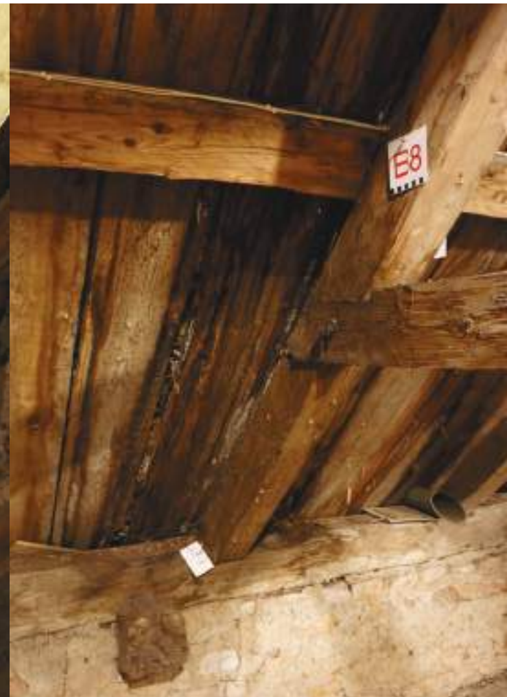
Puutarhan puoleisen kaakkoislapteen lahovaurio ulottuu alempaan lautakerrokseen asti.
