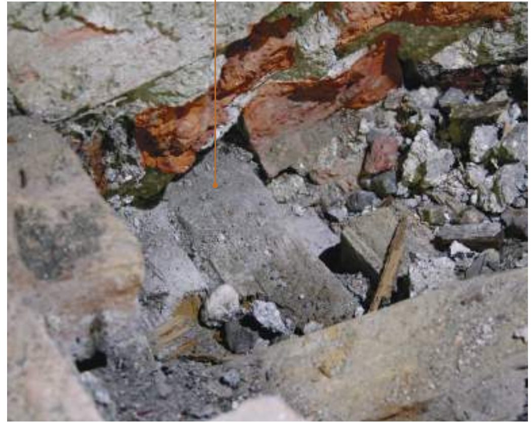
Lounaisjulkisivun avauksessa näkyy muurista kohtisuoraan tuleva alapaarre yläreunan kolouksineen.
