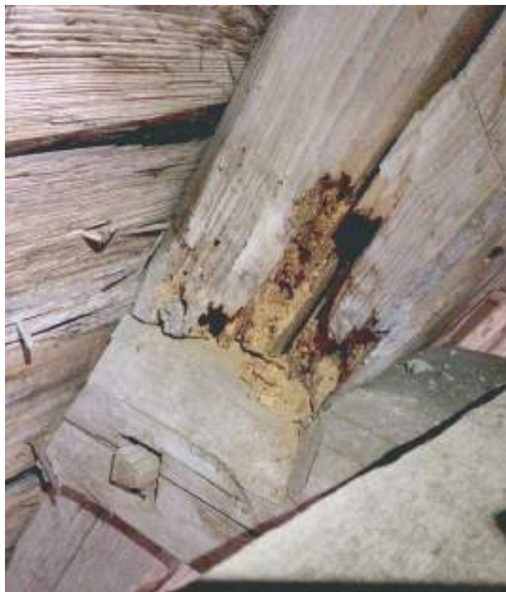
Koko kattorakenteen ainut yläosan lahovaurio koillisen puolen selkäpuun ja ylimmän kitapuun (a) liitoksessa.
