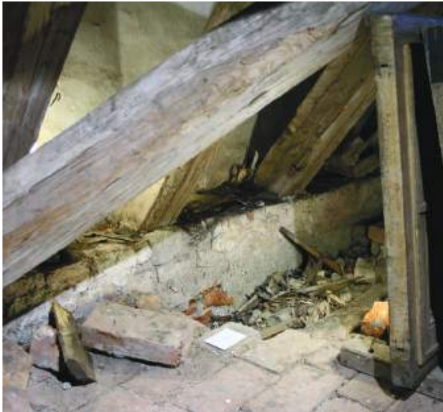
Lounasjulkisivun tutkimuskohta oli jo valmiiksi vaurioituneessa kohdassa.
