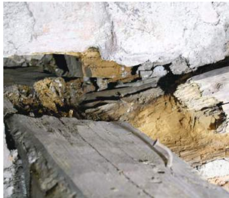
Kuvassa oikealla näkyy muurin sisäisestä liitoskohdastaan täysin lahonnut saksipuu ja kattotuolin selkäpuu. Myös muurin sisällä olevassa kehäpuussa oli selkäpuun kohdalla lahovauriota.
