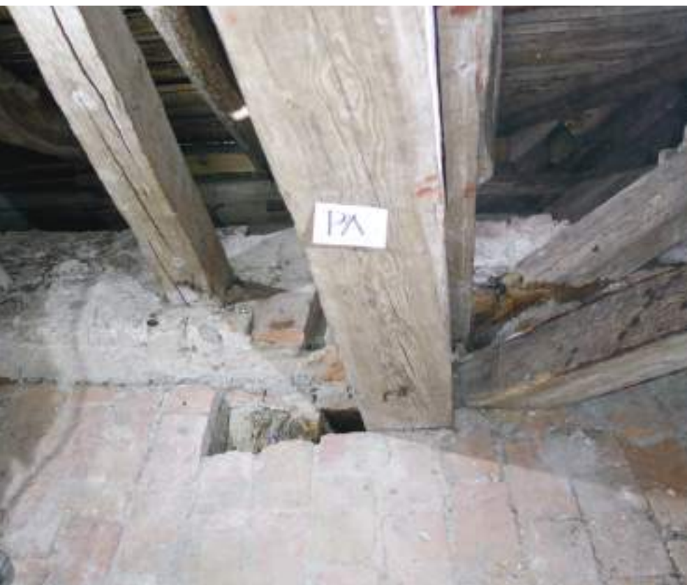
Kuva päätypukista PA ennen rakenteen avausta. Pukin jalan kohdalla oli vanha vesivaurio jonka takia puuosat sekä tiilimuuraus olivat vaurioituneet.
