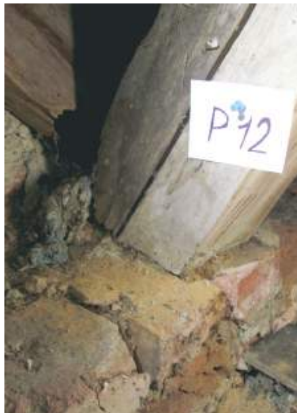
Selkäpuun lahovaurio. Myös takana näkyvä keskiakselin päätykolmioon liittyvä puuosa on alapäästään lahonnut.
