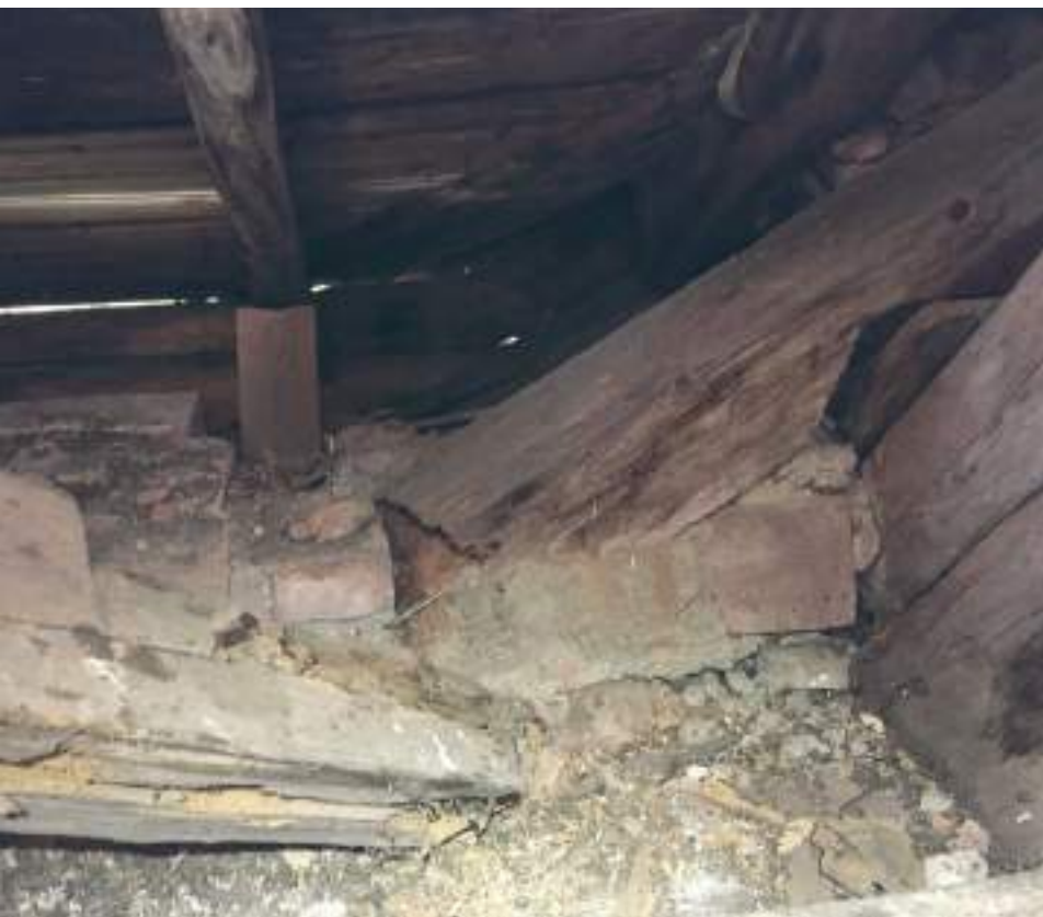
Pukkeja yhdistävä saksipuu on lahovaurioitunut viereisestä kattolyhdystä vuotaneen veden takia. Lounaissivulla on kolme lahovaurioitunutta saksipuuta.
