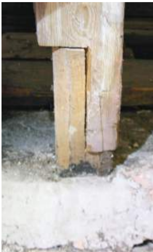
Selkäpuun vanha korjaus.
