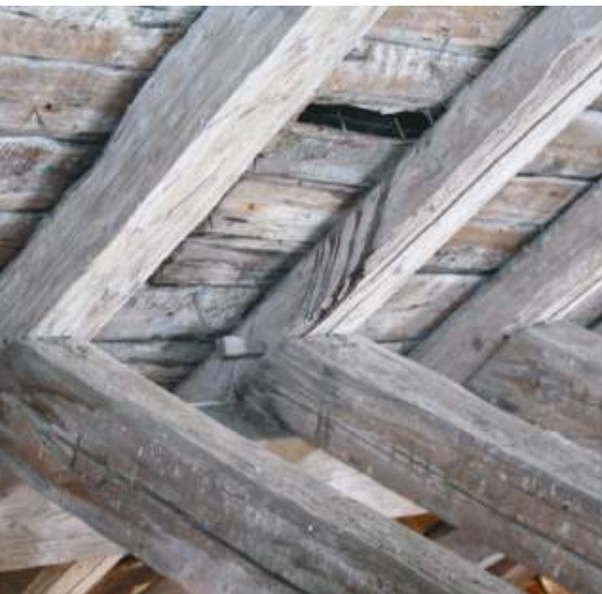
Kattotuolin selkävuiden ja alimpien kitapuiden liitoksia. Osa tapeista on katkaistu, osa ei.
