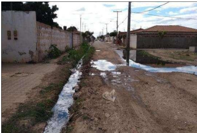
Figura 02: Rua com esgotamento sanitário entupido bairro Dom Avelar, Petrolina – PE
