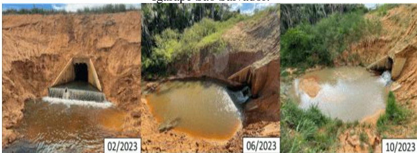
Figura 9. Evidências de erosão e assoreamento ao longo de 8 meses do ponto 02 do Igarapé São Salvador.
