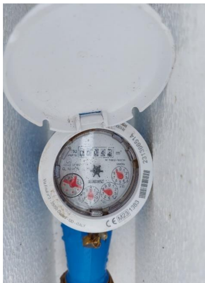
Obr. 25: Domovní vodoměr umístěný na přívodním potrubí do bioreaktoru
