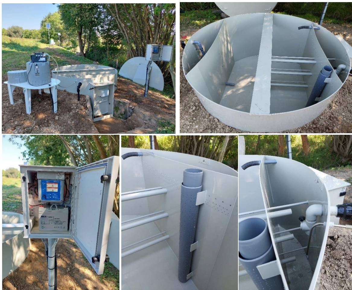
Obr. 20: Ukázka konstrukce bioreaktoru včetně okolních zařízení (datová stanice FIEDLER, vzorkovač ISCO, ...)
