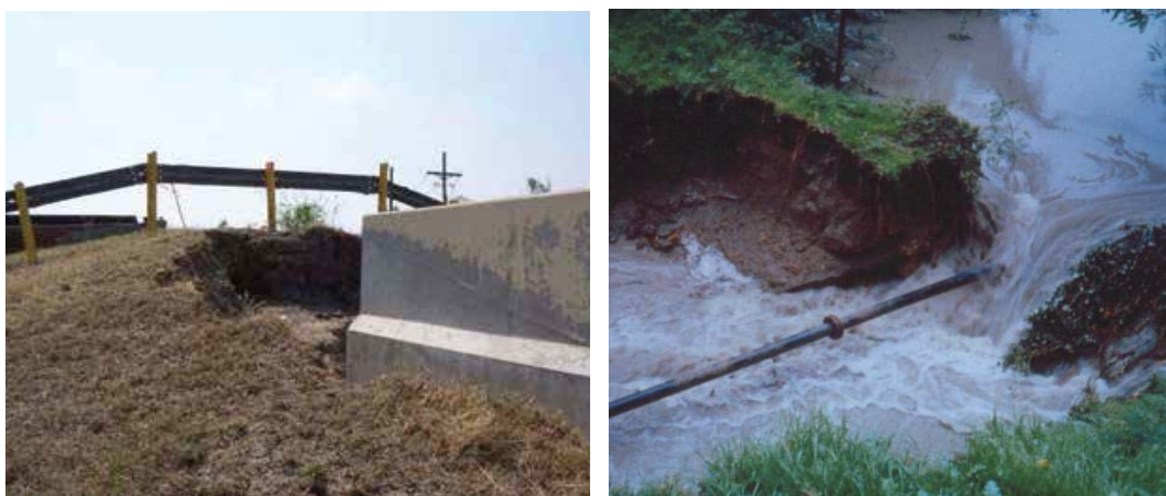
FIGURE 7. Brèche à la transition entre des tronçons de digue en remblai et en béton armé [6] ; Brèche dans une digue, au droit d'une conduite traversante sur le Rhône (Source : SNRS).
