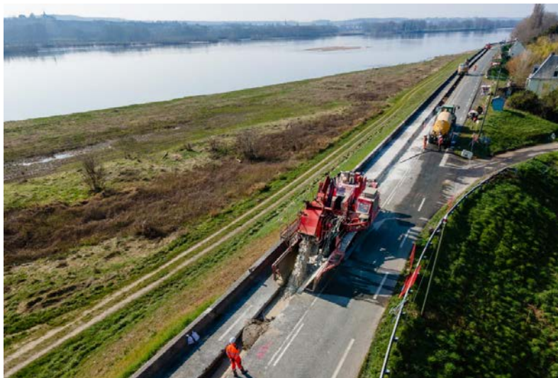
FIGURE 1. Vue générale de la réalisation d'un écran par tranchée de sol mixé (source : DREAL CVL/DETL © Cédric Helsly).
