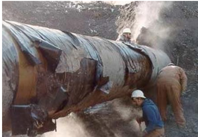
Şəkil 2. İzolyasiya altında qaz və maye ötürücü boru kəmərinin korroziyası.
