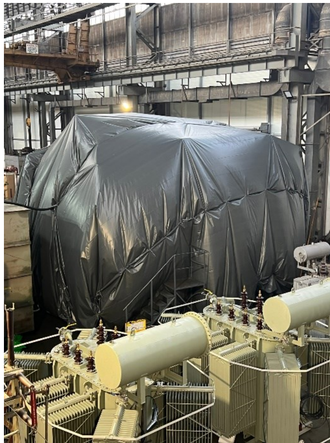
Slika III. Prikaz transformatora prekrivenog najlonom zbog održavanja temperature
