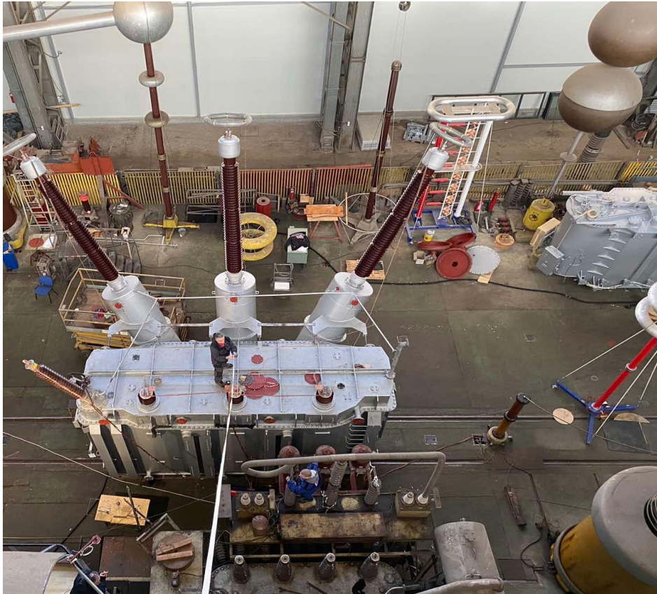
Slika XI. Pogled transformatora odozgo prilikom ispitivanja udarnim naponom
