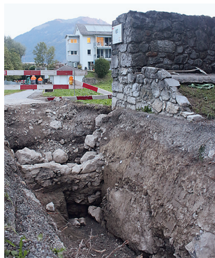
1 Blick auf den freigelegten (l.) sowie einen rekonstruierten (r.) Abschnitt der Letzimauer. © Larissa König, ProSpect.
