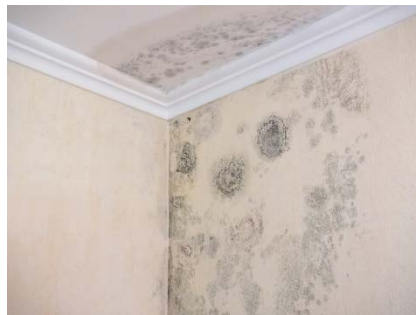
Figura 8. Humedades en techo y paredes [1]
