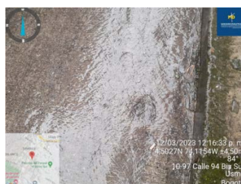
Figura 4. Hundimientos en pavimentación por gárgolas
