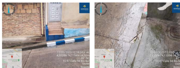
Figura 3. Condiciones físicas de andén sur oriental
