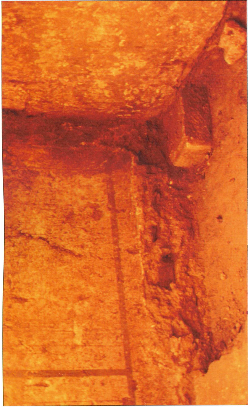
FIG. 9. — Socle d'appui, en arkose, de l'un des piliers dans l'angle oriental et décrochement de l'enduit peint marquant l'emplacement du palier de base de l'escalier disparu.
