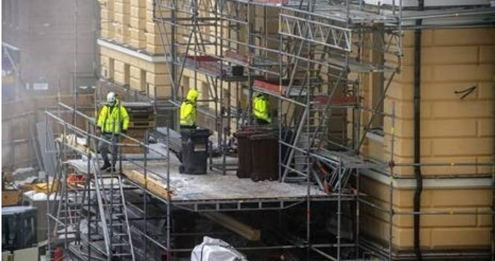
Rakennusmiehiä Helsingissä. Koronartuntoja on esiintynyt paljon fyysisesti raskaan työn yhteydessä, jossa on tiivis työyhteisö. Kuva: Kimmo Penttinen
